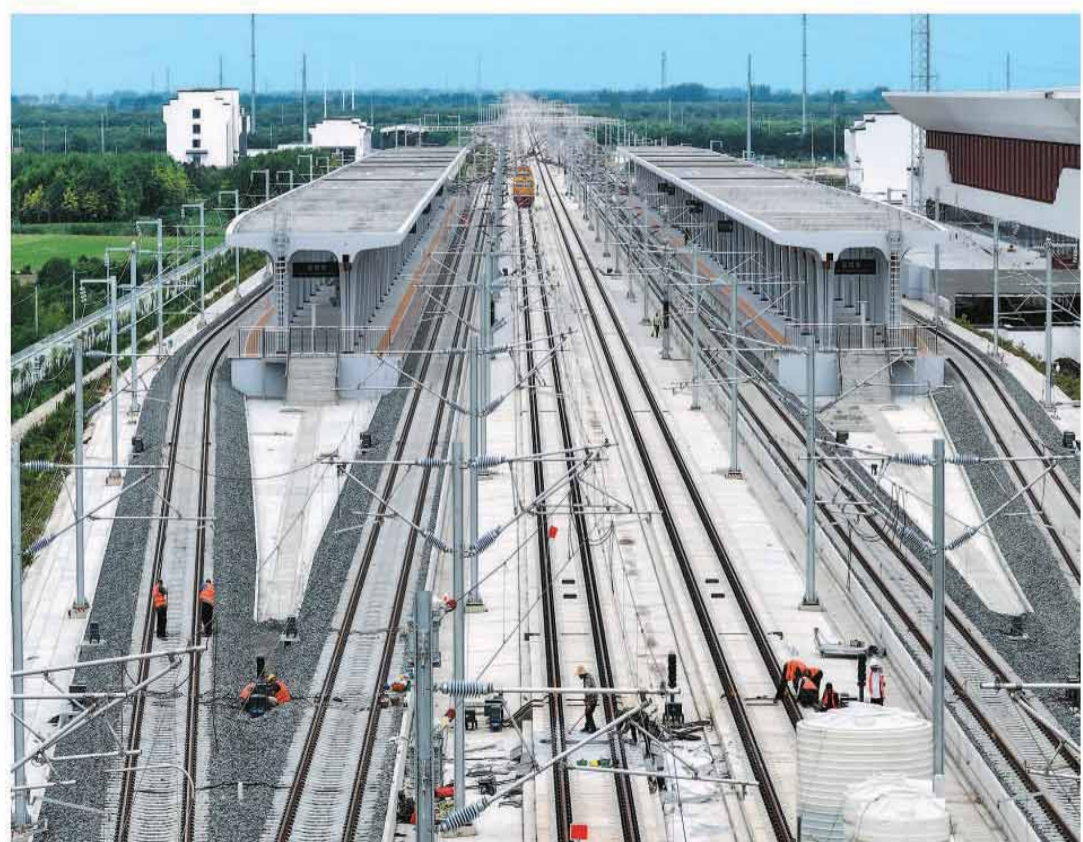
近日,新建安徽阜阳至蒙城至宿州(淮北)铁路(以下简称“淮阜高铁”)正式启动静态验收工作,标志着该高铁主体工程建设基本完成,向着开通运营目标迈出重要一步。淮阜高铁是皖北地区城际铁路网的重要组成部分,新建正线全长约142.5公里。图为工人在位于亳州市蒙城县的淮阜高铁建设现场施工。胡卫国摄(人民图片)
