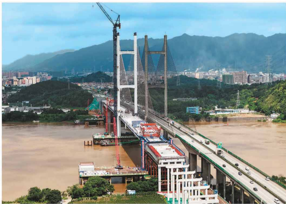
近日，广肇高速改扩建工程新建金马大桥顺利合龙，为年底进行交通导改奠定坚实基础。该桥全长1936.6米，串联广东省肇庆市高要区与佛山市三水区，是广肇高速改扩建项目控制性工程。大桥建成通车后，新旧两座金马大桥均变为单向四车道通行，通行能力翻倍，成为支撑广佛肇一体化的“黄金通道”。图为广肇高速改扩建工程新建金马大桥（左侧）。 新华社记者 邓华摄
