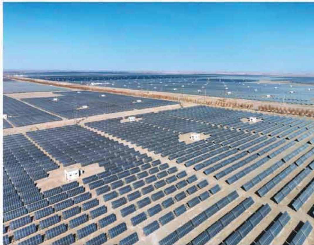
2月23日，甘肃省酒泉市金塔县红柳滩光伏电站光伏阵列，源源不断输送绿色能源。
