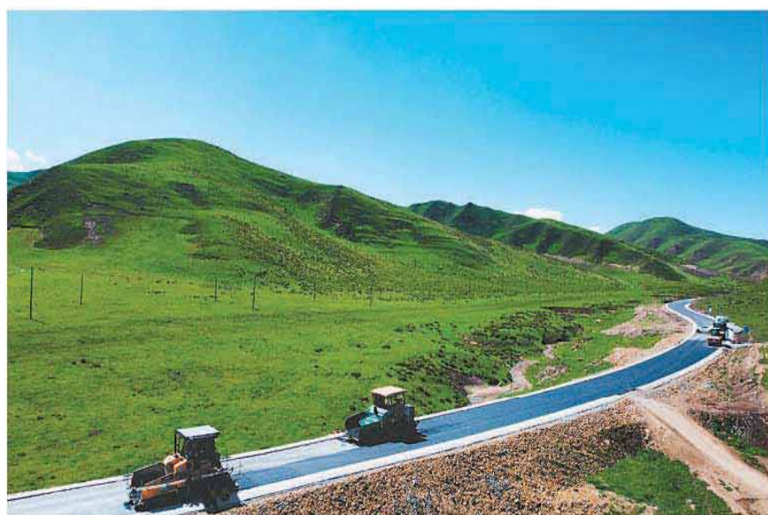
近日，中建新疆建工土木工程有限公司承建的甘肃省合作市G316至S326连接线（西宁道至勒秀镇）公路工程项目路面基层基本完成施工。项目建成后，将进一步优化合作市“一心三区”交通布局，推动打造“30分钟”城市圈，更好开发利用当地优势资源，助力区域经济社会高质量发展。 王琦摄（人民视觉）
